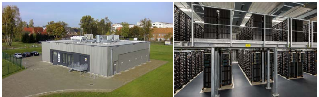
Europas - nach Investorenangabe - größter Batteriespeicher steht in der Nähe von Schwerin (Fotos: Wemag)
